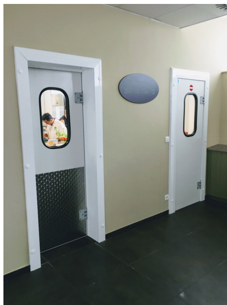
De klapdeuren zijn eenzijdig geblokkeerd om ongelukken te vermijden
